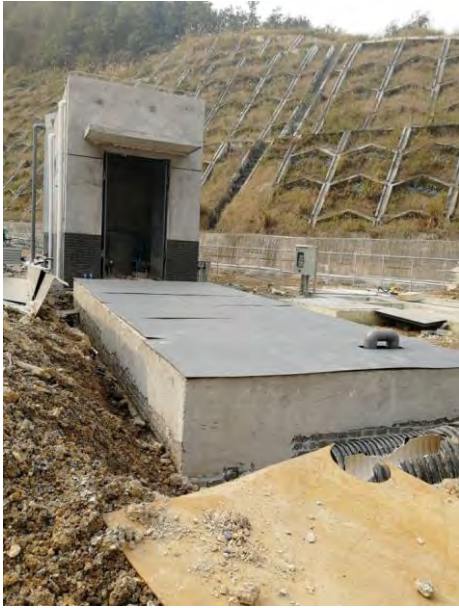
地埋式生活污水处理站
