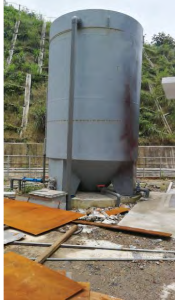
生产废水处理站（混凝+过滤）
